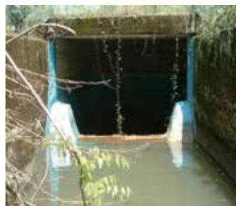
サイホン 20年経過状況
