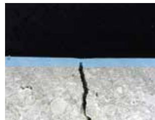
強度が低くひび割れ部で損傷
