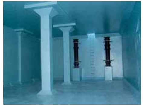
●水道施設配水池 1988年 防水性 耐水性 水質安全性
