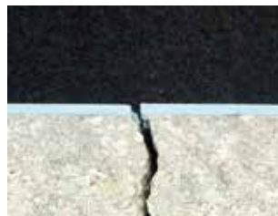
ひび割れに追従できず破断
