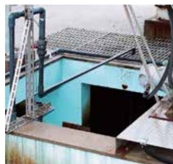
浄水場混和池 20年経過状況
