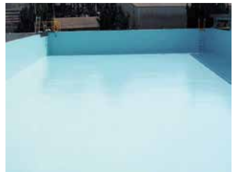
●工場廃水槽 2004年 防水性 耐薬品性 土壌汚染・地下水汚染未然防止対策
