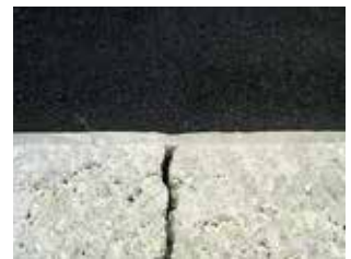
ひび割れ部分で膜厚減少
