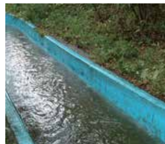
農業用水路 20年経過状況
