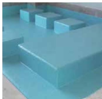
薬品設備架台
